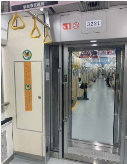
消火器の矢印マークがあるが消火器らしきものが見えない
